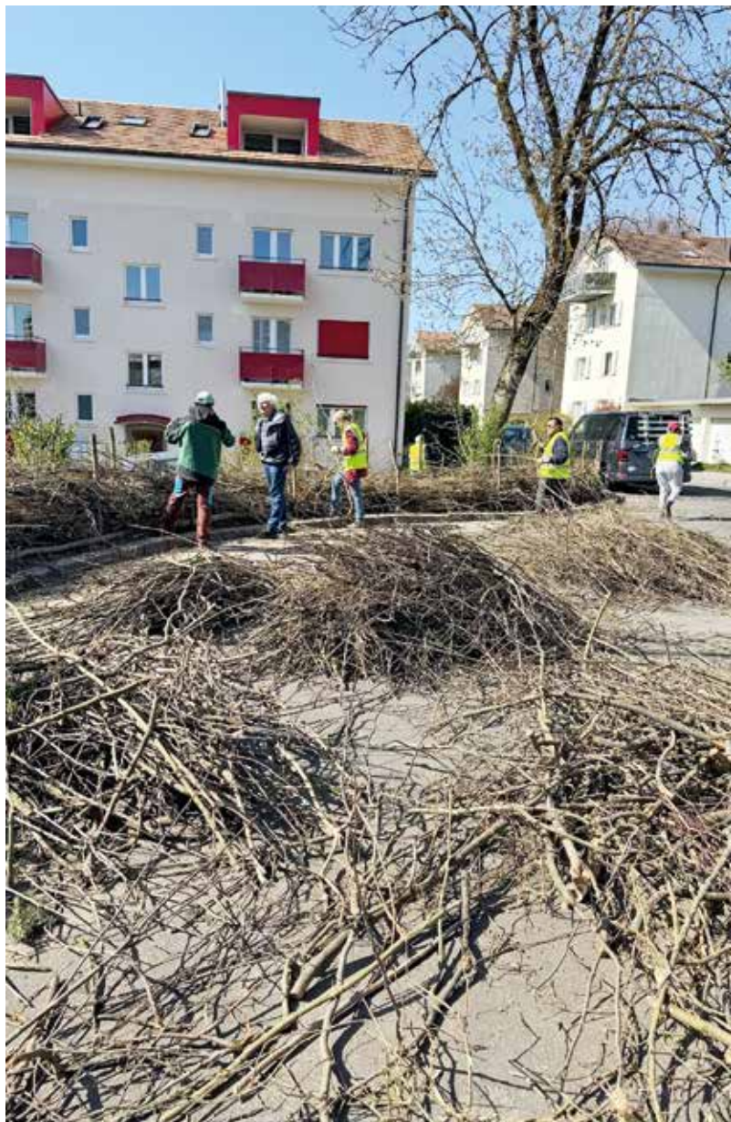
Construction d'une haie de Benjes près de Europaplatz pour favoriser la biodiversité.
