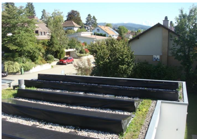
Photovoltaikanlage auf dem Pfarreisaal
