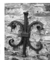
Mauerverankerung im Kloster St. Hildegard Eibingen bei Rüdelsheim
